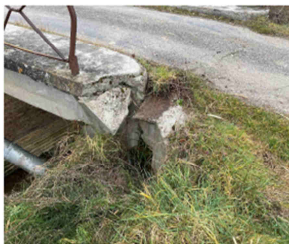
Eclat important sur l'about du trottoir amont côté rive droite
