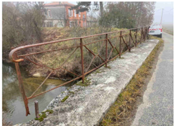
Garde-corps arraché côté rive gauche aval
