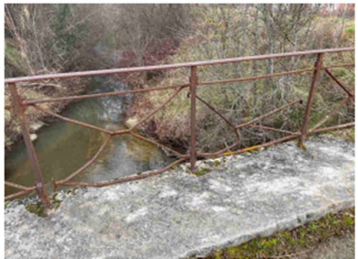
Garde-corps sectionné côté aval
