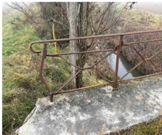
Garde-corps tordu côté rive droite amont
